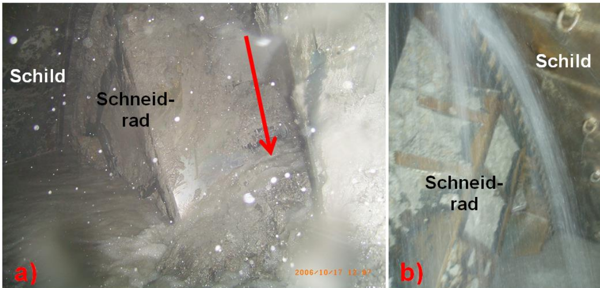
Abbildung 6.30: Teilabsenkung des Erdbreis a) Wasseranstieg in der Abbaukammer durch massiven Wasserzufluss (Pfeil) von der Ortsbrust durch eine Schneiradöffnung b) Wasserzutritte über den Schild mit Anstieg des Wasserspiegels in der Abbaukammer
