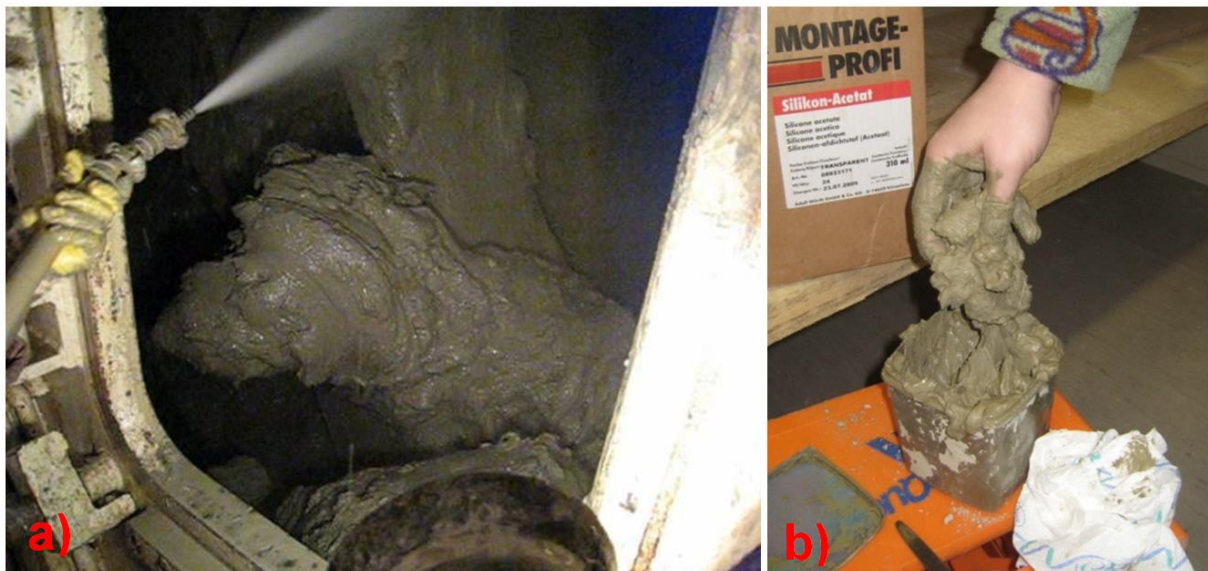
Abbildung 6.67: a) Blick aus der Schleuse in die Abbaukammer: Verklebungspasten an der Schneidrückseite [59] b) Probe einer breiigen Verklebungspaste [67]
