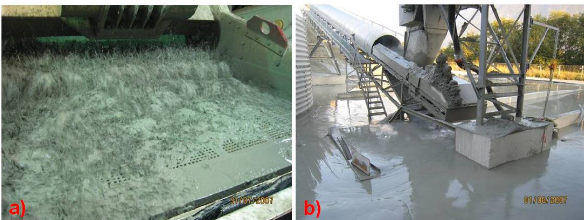
Abbildung 6.97: a) Überlauf des Grobsiebs infolge verklebter Siebmaschen [59] b) Überschwemmung der Separationsanlage infolge übergelaufener Grobsiebe [59]
