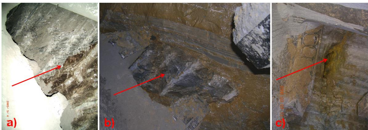
Abbildung 6.5: a) Störung (Pfeil) zwischen zwei unterschiedlichen Gesteinen b) Linsenförmiger Härtling (Pfeil) als Einlagerung in Gesteinen mit geringer Festigkeit [119] c) Karstspalte (Pfeil)
