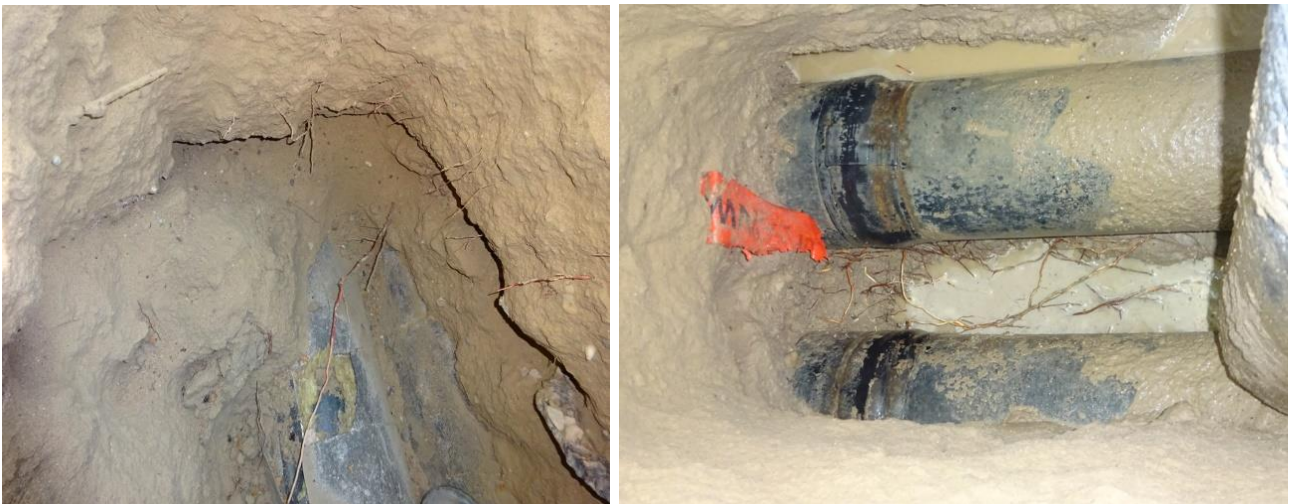
Abbildung 41: Feinwurzeln in der Bettung bei Kopfloch 1 (links) und Feinwurzeln an und zwischen Vor- und Rücklauf bei Kopfloch 2 (rechts)
