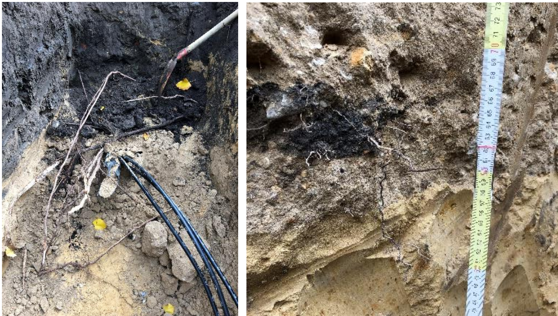
Abbildung 51: Wurzelwuchs in Trennfläche zwischen Telekommunikationskabel und Bettung (links) und zwischen Sandbettung und Tragschicht (rechts) bei Aufgrabung Nr. 6
