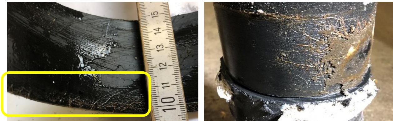
Abbildung 15: Wurzelanwuchs in den nicht-stoffschlüssig verbundenen Spalt zwischen Muffe ohne Dichtband und Kunststoffmantelrohroberfläche (links), Wurzeleinwuchs in eine Muffenverbindung, bei der durch bewusst eingebrachte Fremdstoffe keine adhäsive Verbindung zwischen Muffenrohr und Ummantelung des KMR erfolgen konnte (rechts) [97, S. 27]
