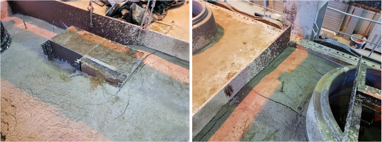
Abbildung 54: Vereinzelt Risse in Material C an Verbau (links) und Schacht (rechts)
