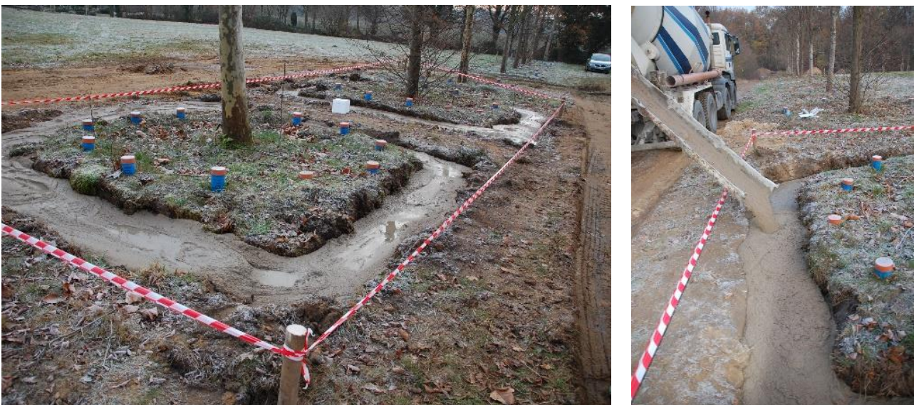
Abbildung 71: ZFSV kurz nach Einbau um die Versuchsbäume (links) [96, S. 68], Einfüllen des ZFSV in die Baugrube mit Fahrmischern (rechts)
