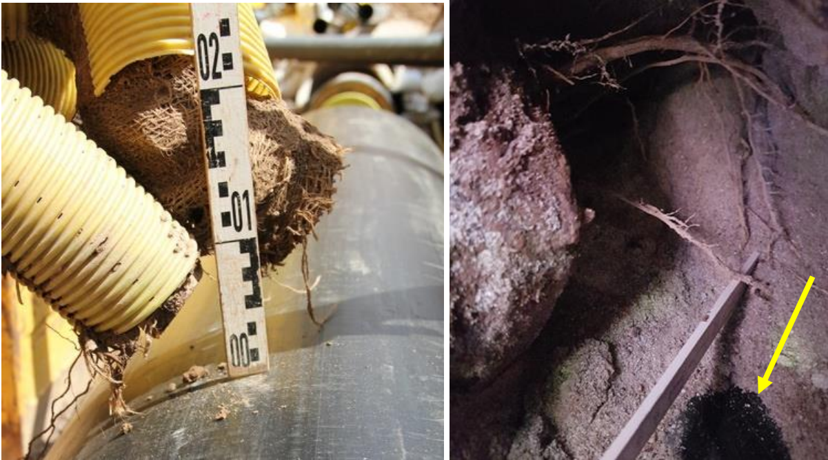
Abbildung 42: Gekappte Starkwurzel nah an der Rohroberfläche während der Neubaumaßnahmen der Fernwärmetrasse 2013 (links; Bildquelle: ZORN Sachverständigen Büro Gartenbau) und an der Rohroberfläche während der anlassbezogenen Aufgrabung 2020 (rechts, gelber Pfeil zeigt die Rohroberfläche)
