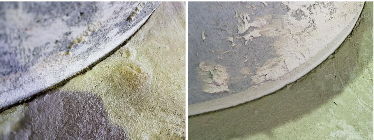
Abbildung 55: Spalt in Material A zwischen ZFSV und Schachtoberfläche (links) und Material B (rechts)
