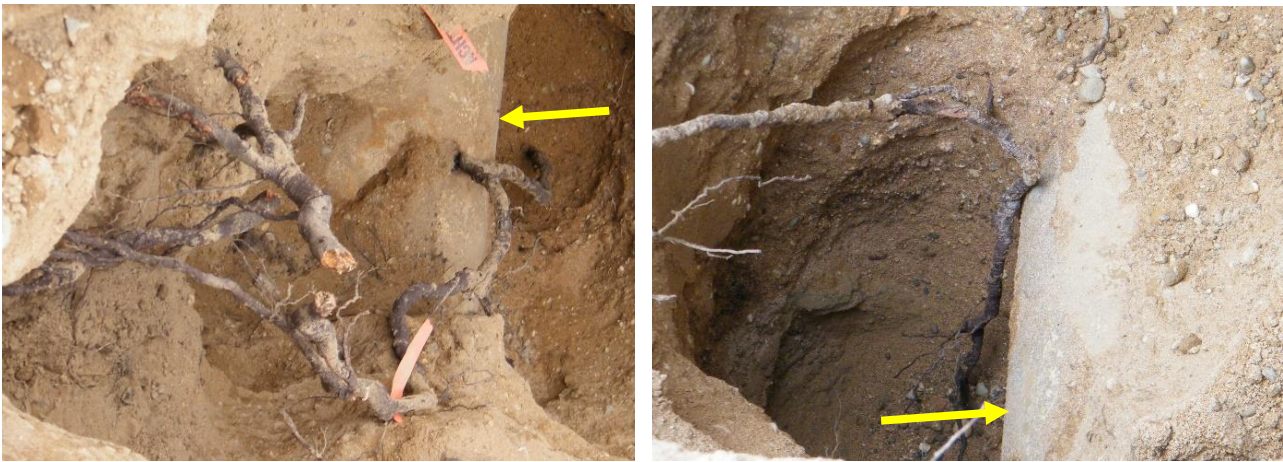
Abbildung 39: Blick von der GOK in den Leitungsraben: Interaktionen zwischen Wurzeln und Fernwärmerohrleitungen, Vorlauf (links) und Rücklauf (rechts) jeweils mit gelbem Pfeil markiert
