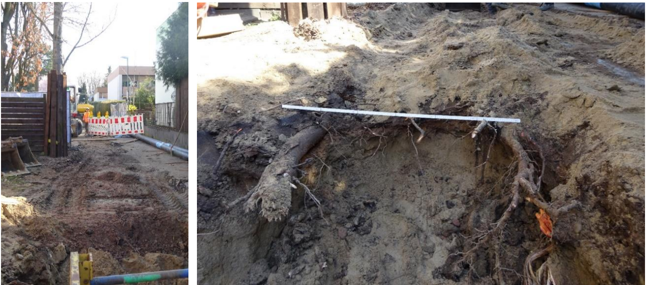
Abbildung 49: Baum 1 direkt an Fernwärmetrasse (links), Wurzeln in 0,2 Metern Tiefe unter GOK oberhalb der Fernwärmetrasse in ca. zwei Metern Abstand von Baum 1 und fünf Metern Abstand von Baum 2 (rechts)
