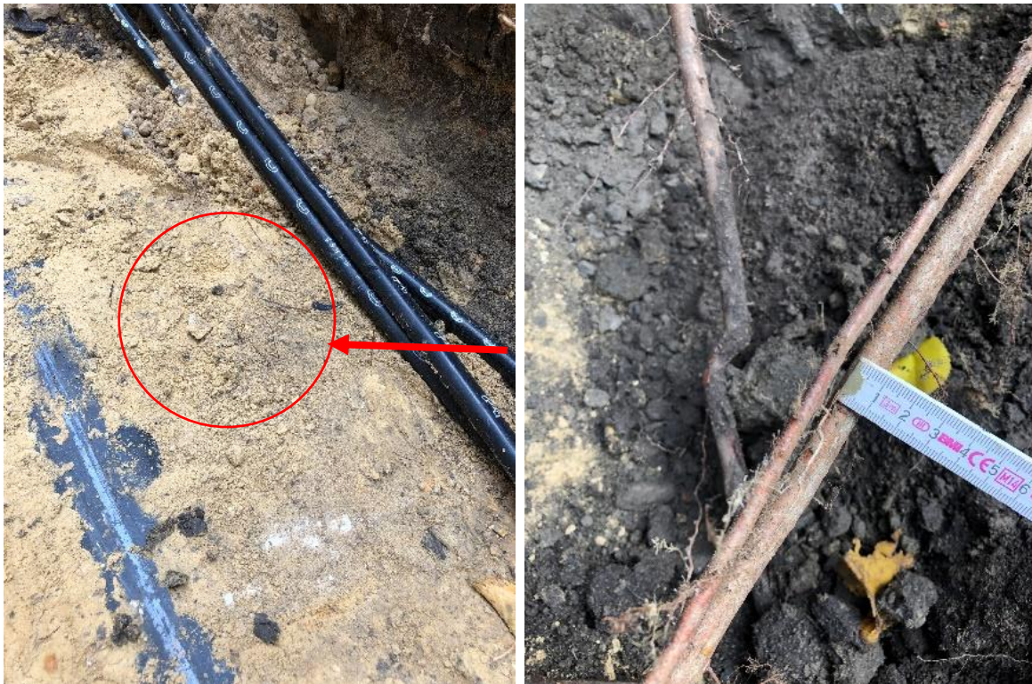
Abbildung 44: Feinwurzeln in Bettung der Fernwärmeleitung (links; roter Pfeil zeigt zur Fernwärmeleitung, eingekreist sind die Feinwurzeln, rechts im Bild das Telekommunikationskabel) und Wurzeln, die an dem Telekommunikationskabel axial entlang wuchsen (rechts; ohne Telekommunikationskabel)
