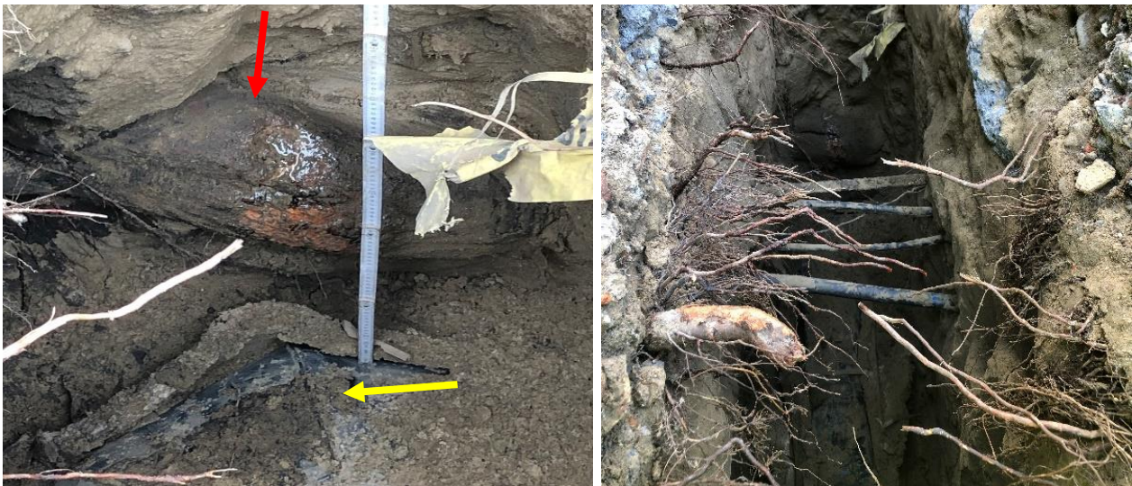
Abbildung 45: Starkwurzel (19 Zentimeter) neben der Fernwärmeleitung (links; roter Pfeil Wurzel, gelber Pfeil Fernwärmeleitung) und Wurzelwachstum oberhalb der Fernwärmeleitung (rechts)
